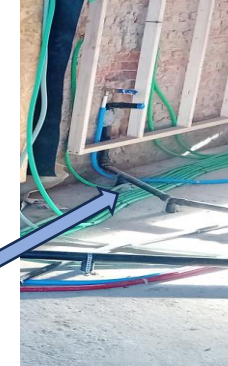
Afvoerleiding van keukenlavabo
